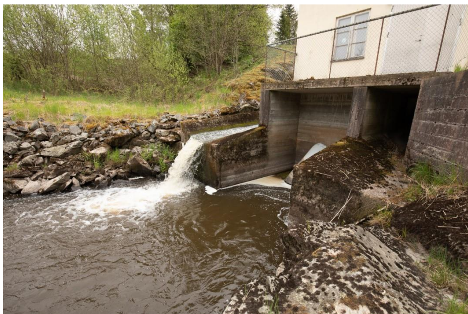
Figur 13. Häreholms kraftstation från nedströmssidan
