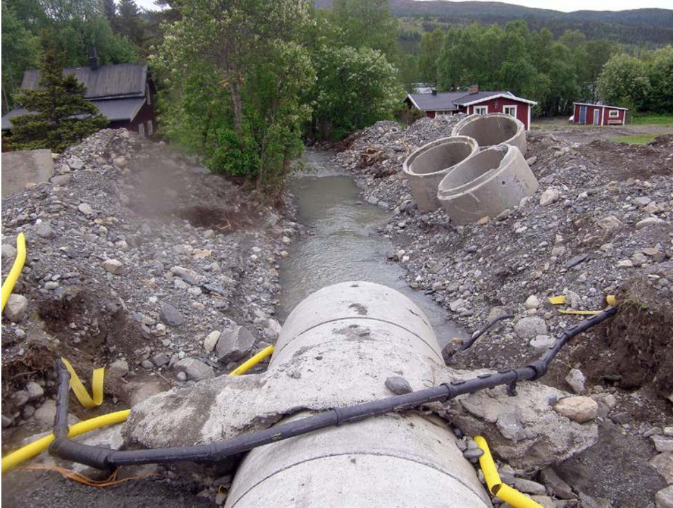
Foto av de igenproppade och bortspolade trummorna under järnvägen i Åre 18 juni 2010. Foto Björn Olofsson, Länsstyrelsen i Jämtlands län.
