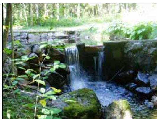
Figur 9. Vandringshinder i grenen av Dammsjöbäcken (tabell 3, hinder 13).
