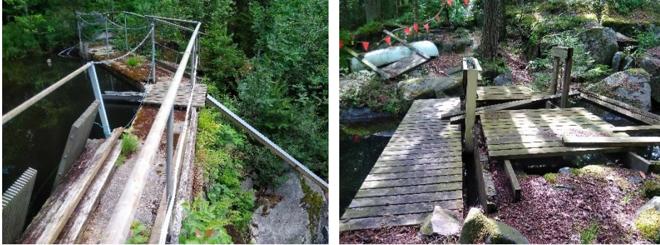
Figur 5. Bild t.v. Regleringsdammen vid Gravsjöns södra spets. Bild t.h. Fördämningskonstruktionen som reglerar vatteninflödet till regleringsdammen.
