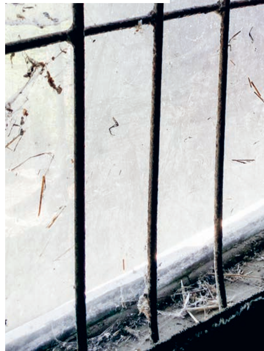
Gallerstänger av armeringsjärn är inte tillräckligt hållfasta och utgör därmed en skaderisk för hästarna i stallet.
