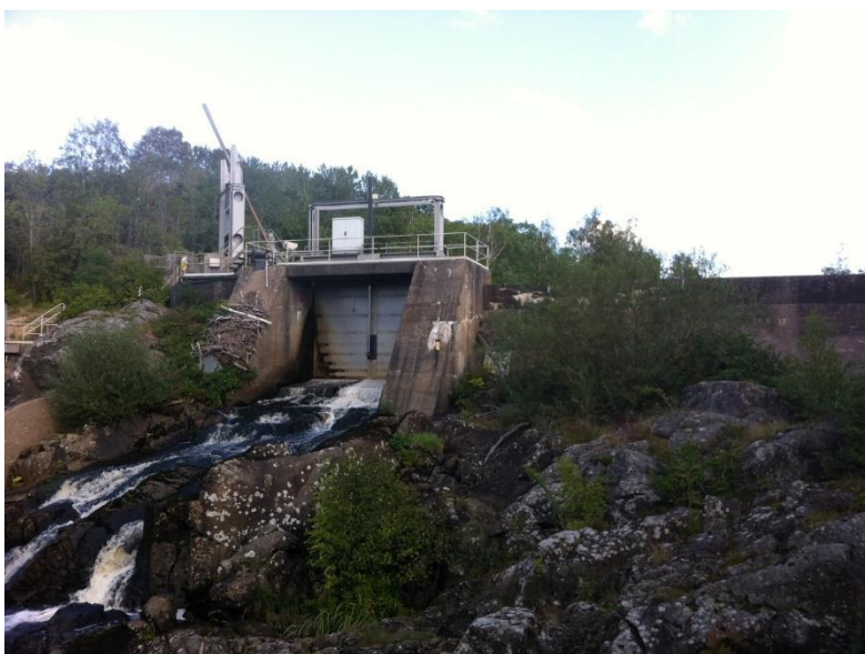
Figur 9. Flodluckan vid Fossumsbergs kraftstation
