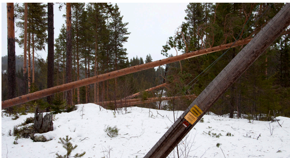
Träd som fallit över elledningar – så kallad stormfällning. Foto: Jämtkraft AB.
