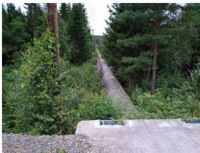
Figur 27. Den långa tuben från Bua damm ner till Gisslefors kraftstation
