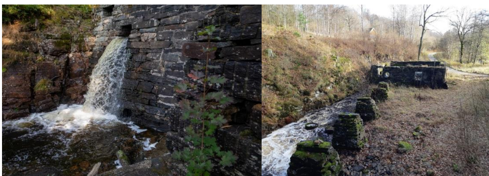
Figur 6. Bild t.v. dammen med utskov vid Nåkälla kvarn. Bild t.h. översiktsbild. Foto Länsstyrelsen.
