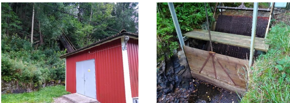
Figur 18. Bild t.v. Hultafors kraftverk. Bild t.v. Intagsgallret uppe i intagskanalen direkt innan tub.
